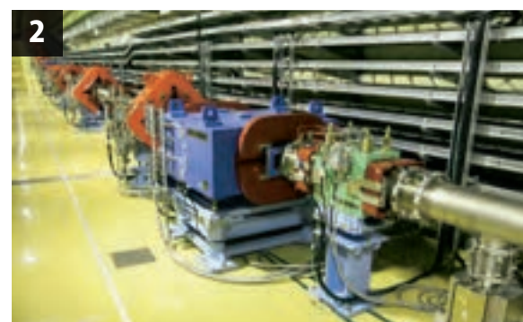
3GeV 陽子ビーム輸送ライン 超高真空のビームダクト内の 3GeV 陽子ビームを、地下に建設されたトンネル内を通して、300mほど離れた物質・生命科学実験施設まで導きます。
