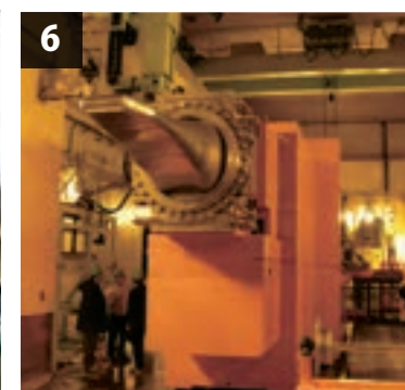
中性子生成水銀ターゲット 中性子を発生させるための標的。水銀を内包 しており、水銀自体が循環し放熱する仕組み です。
