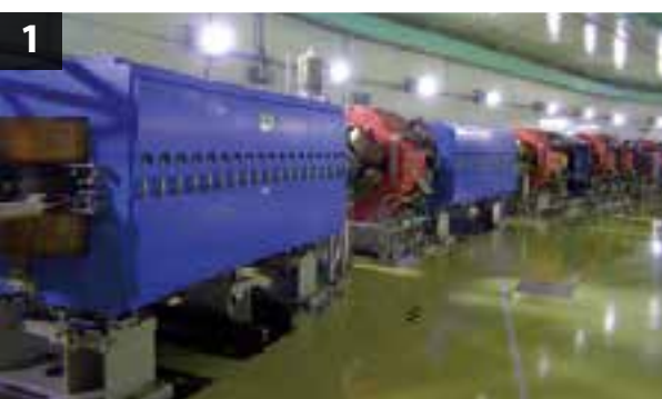
3GeV 陽子シンクロトロン 線形加速器から送り込まれる陽子を加速・周回するための電磁石がリング状にずらりと並ぶ陽子シンクロトロン。 陽子を 30 億電子ボルト(3GeV: 光速の約 97%)まで加速します。
