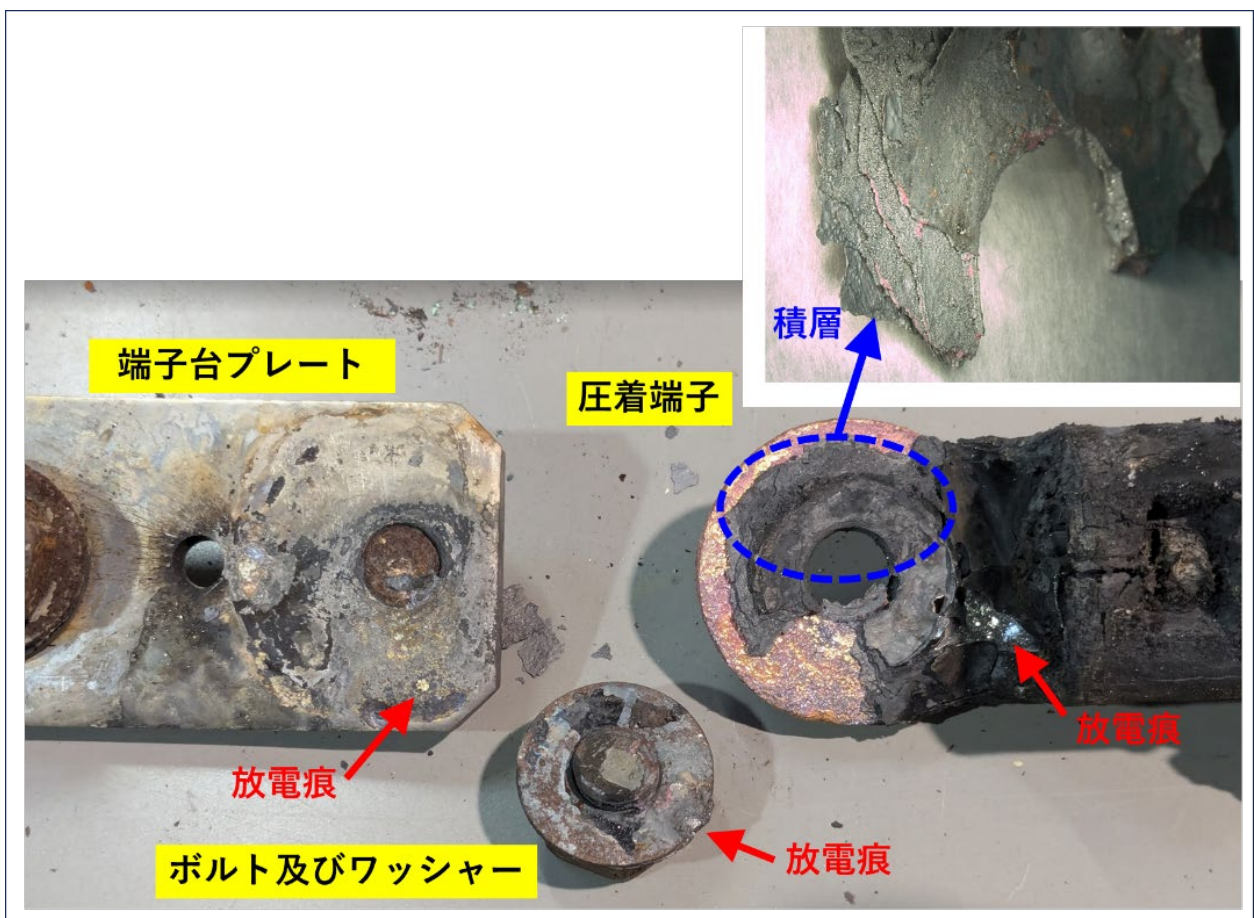
図11 端子台プレート、圧着端子、ボルトおよびワッシャーの状態
