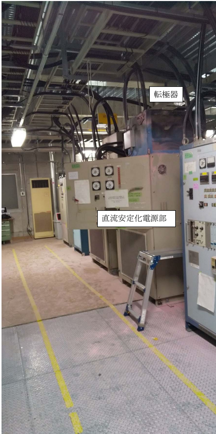
図4 当該電源装置の設置状況
