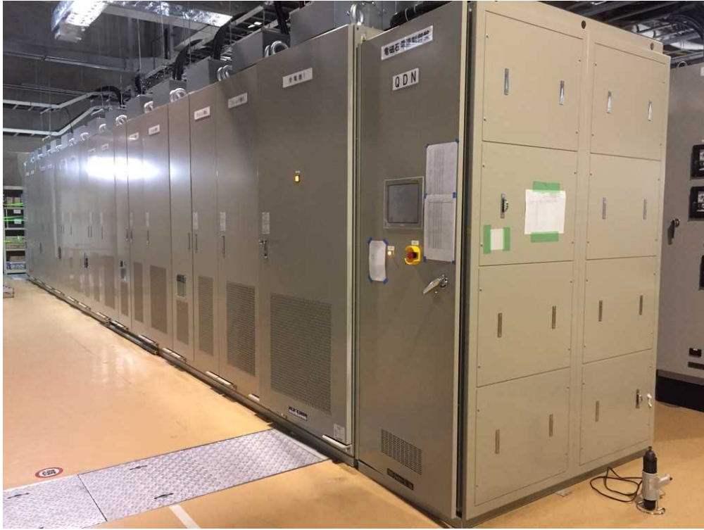
図4 QDN 電磁石電源の設置状況（幅 13.3m×高さ 2.7m×奥行 2.4 m）
